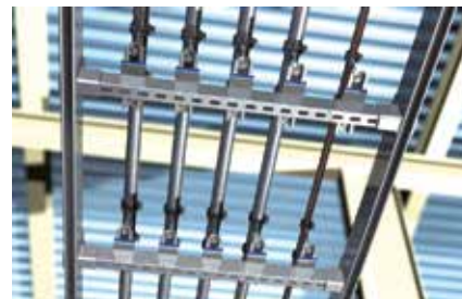
Tubazione sostenute con elemento di scorrimento FCS
